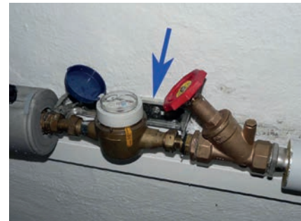
Die Einbausituation: Der Wasserzähler ist in der Anschlussgarnitur (Pfeil) fixiert.
